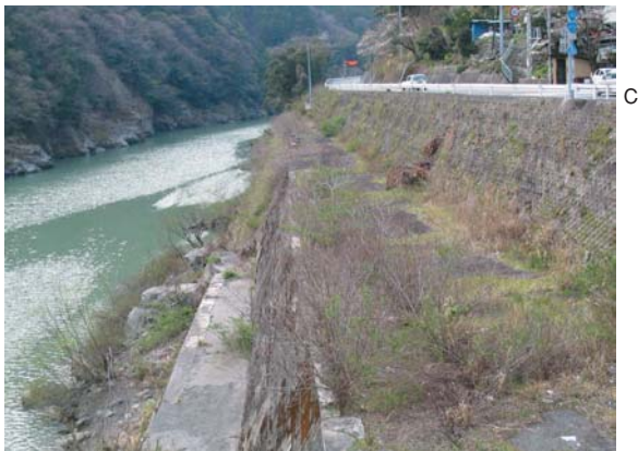
写真1 秋葉ダム湖の堆砂の影響（2004年3月29日） 佐久間町大輪地区では、1958年に約12km下流にできた秋葉ダム湖の堆砂の影響で川床が著しく上昇し、洪水の度に水害を受けるようになり、2度にわたって県道の付け替え工事を行わざるを得なくなった。当然住民の生活の場も、同時に山側へ山側へと急斜面の移住を余儀無くされた。 A：昔の生活の場 B：嵩上げされた県道のレベル C：更に嵩上げされた今の県道
