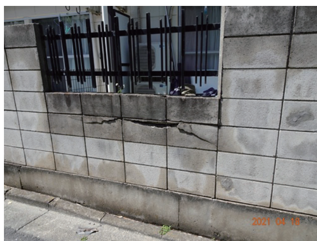
トンネル工事により生じたブロック塀の損傷
