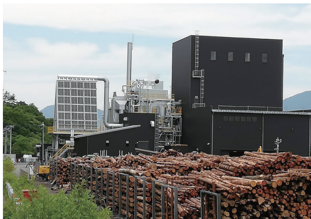
信州ウッドパワー（株）の木質バイオマス発電所
