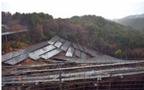
静岡県伊豆高原メガソーラー視察（2019年3月7日）。傾斜地の山林の大規模伐採により、森の保水力の低下、土砂流出、洪水、景観悪化、豊かな漁場やダイビングスポットの水質汚濁、生態系、地元産業への甚大な影響が懸念される
